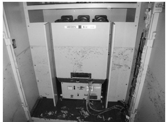
Fig. 5 22kV Switchgear Interior
